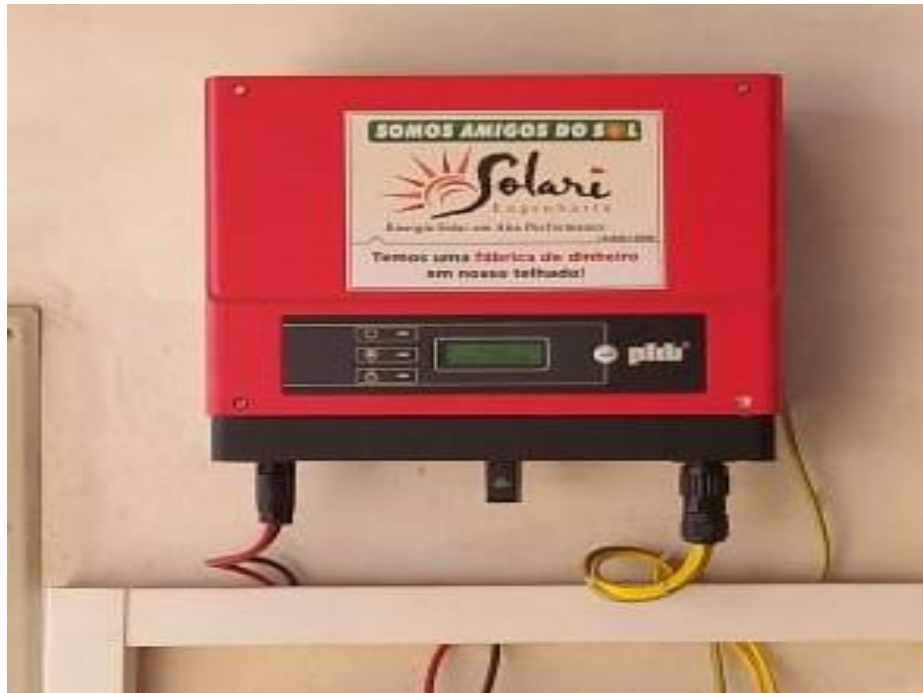
Figura 8 – Controlador de carga
