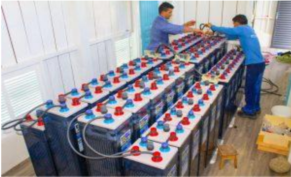
Figura 7 – Baterias estacionárias solares
