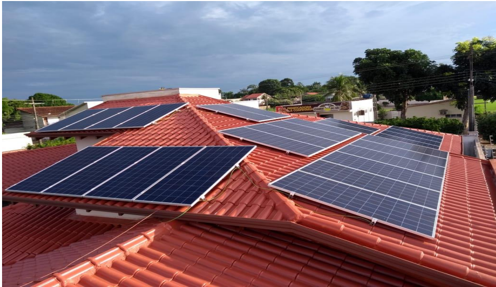
Figura 5 – Módulos fotovoltaicos instalados sobre telhado cerâmico
