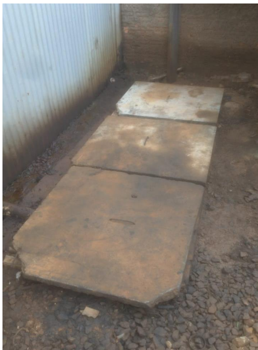
Figura 16 – Caixa separadoras de água e óleo do empreendimento
